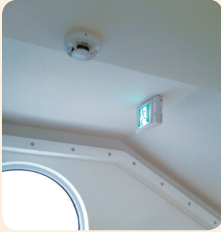
최상층 계단 천장에 단독경보형감지기 설치 우수
