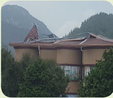
<강풍으로 인한 지붕 파손>
