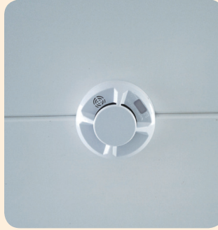
단독경보형감지기 설치 양호
